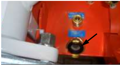
Рис. 80: Грязеулавливающий фильтр на входе воды
